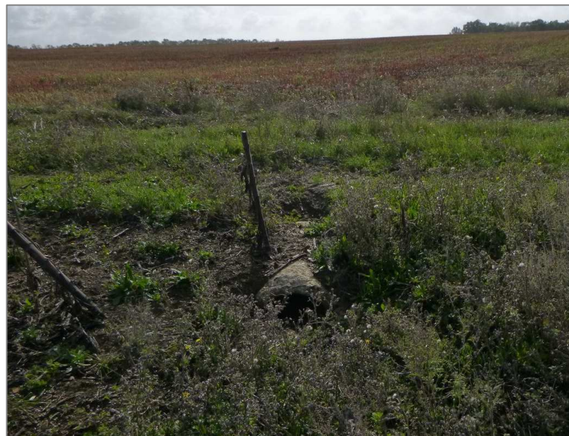
Photographie 17 : Ancien fossé de drainage et buse (au centre) au niveau de l'implantation de l'éolienne E1
